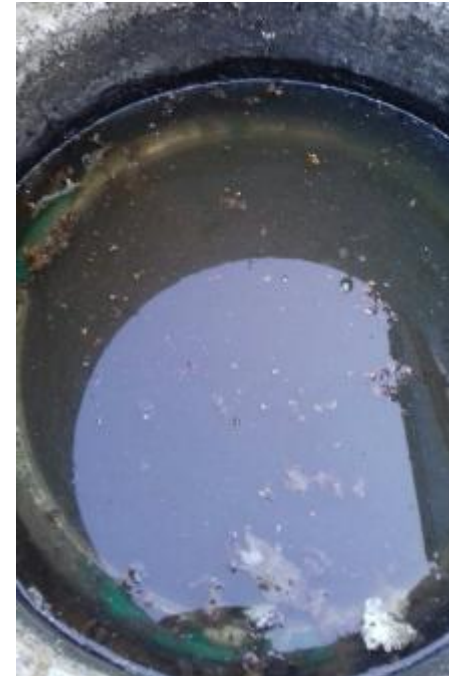
Fosse en charge (mauvais écoulement)
