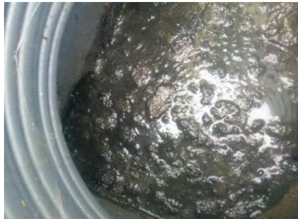
Stagnation d'eau dans un regard de répartition (filrière d'assainissement colmatée)
