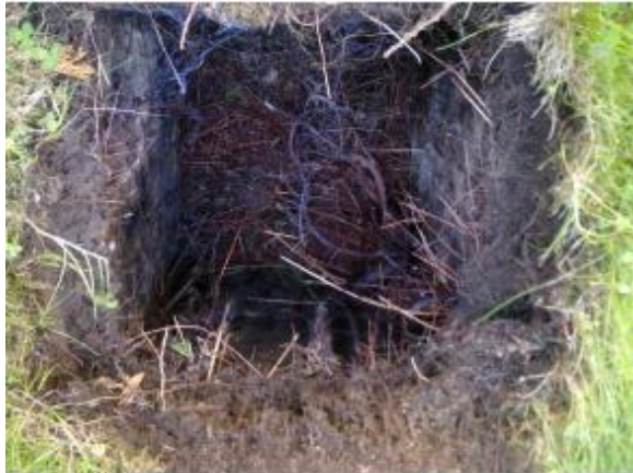
Présence de racines empêchant l'écoulement des effluents
